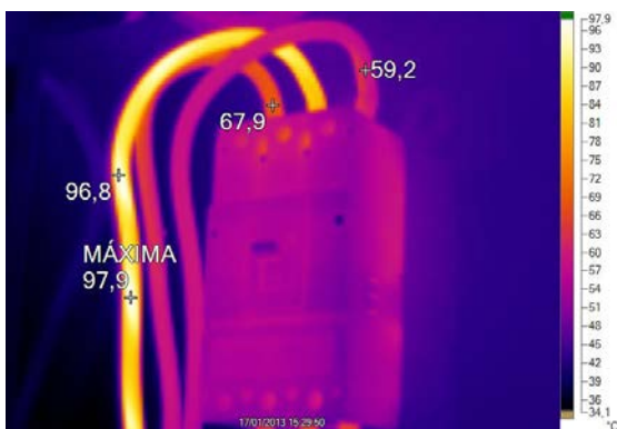
DESBALANCE DE CARGAS TRIFÁSICAS
